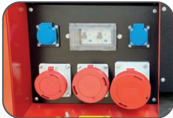
2. TOMAS Cuadro de tomas para toma de fuerza.
